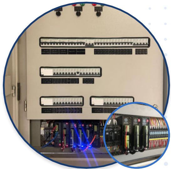
نصب ماژول های سخت افزاری در تابلو برق و اتوماسیون و کنترل تجهیزات و فرآیندها
