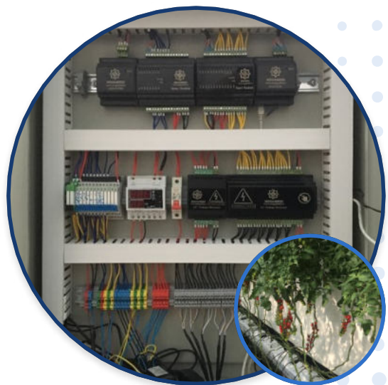
سامانه پایش و کنترل اقلیم گلخانه
